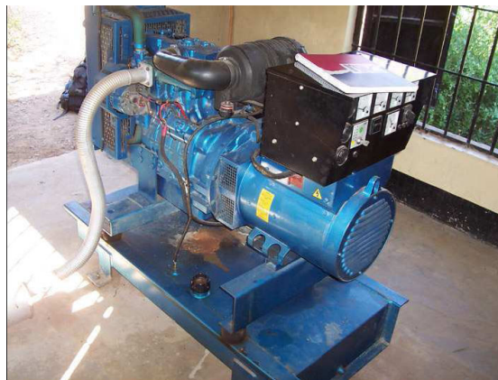
Figura 8 Generador diesel para alimentación a bomba sumergida (Gorfam, Tanzania, J.A.Mancebo 2007)
