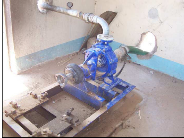
Figura 5 Moto-bomba con averías mecánicas (Barazani, Tanzania, J.A.Mancebo2007)
